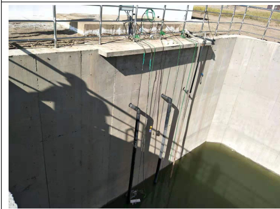
渗滤液调节池
