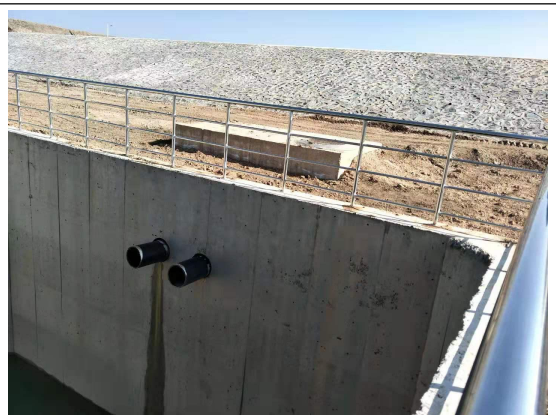
渗滤液导排管
