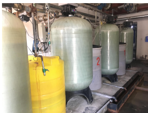
软化水系统 (Na + 交换器)
