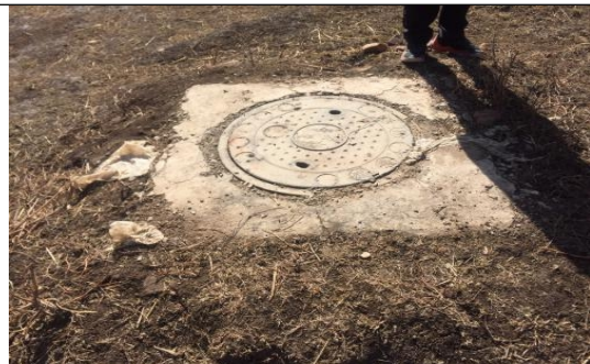
水泉村上沟供水工程控制井
