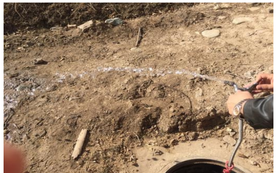
水泉村饮水安全工程供水井
