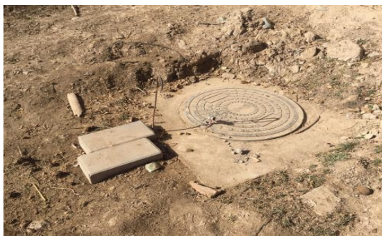
水泉村饮水安全工程供水井
