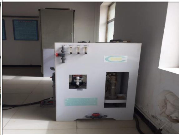
安远水厂二氧化氯消毒器
