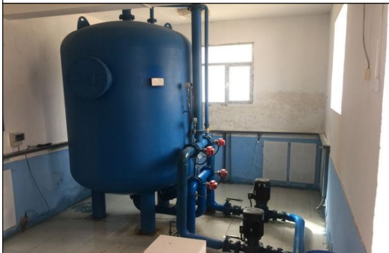
西大滩马场村水厂一体化净水机
