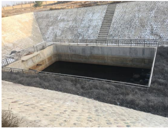
渗滤液调节池
