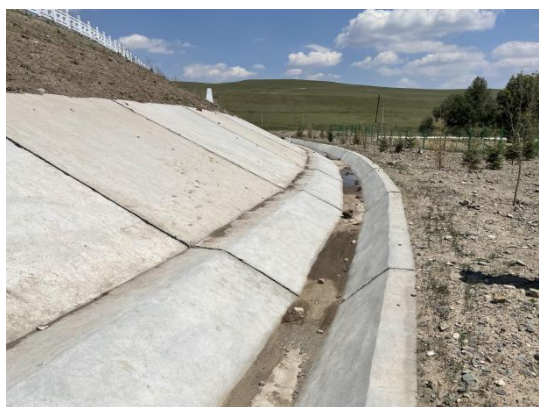
黄草川调蓄水池截排水沟
