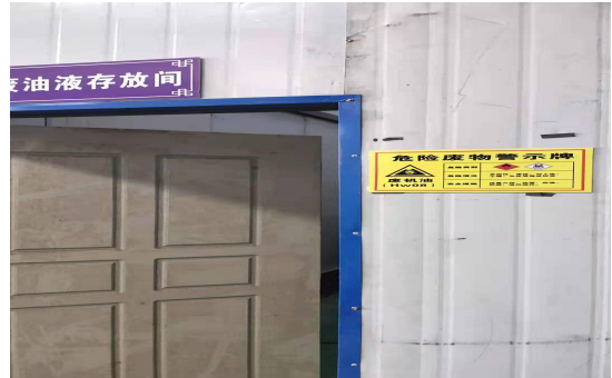
废油液暂存间
