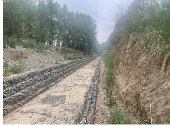
打柴沟安家河村格宾石笼衬砌梯形排洪渠及植被恢复情况
