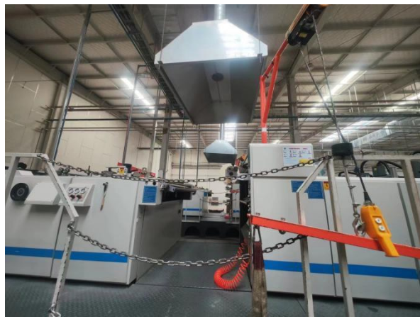
烫金机+UV 上光机+覆膜机 顶部安装废气集气罩
