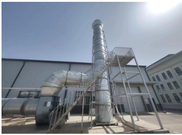
有机废气排气筒
