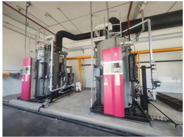
2台天然气锅炉
