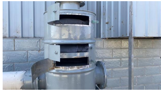
喷漆房活性炭吸附装置
