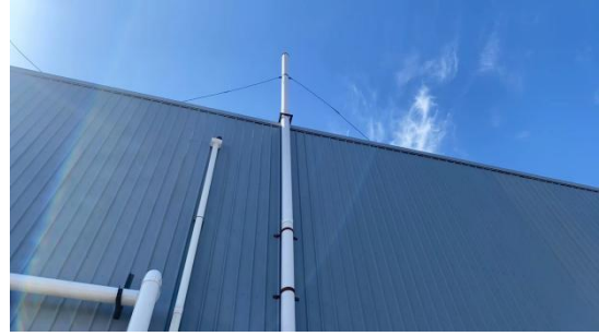
打磨工段排气筒
