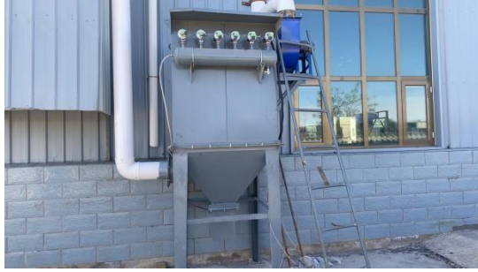
打磨工段布袋除尘器
