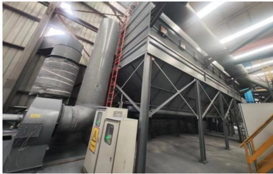
一号线除尘器 (2) 后端接排气筒
