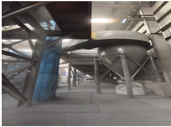
一号线除尘器 (2) 前端旋风收尘
