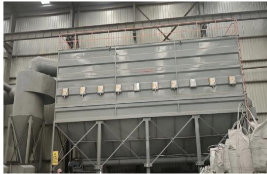
一号线旋风+布袋除尘器 (3)
