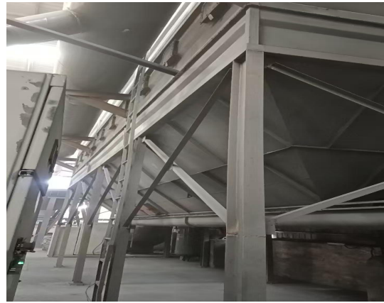
一号线布袋除尘器 (2)
