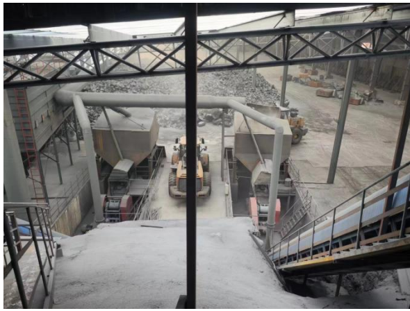
原料准备间（二个进料口+二台颚破+二个 大倾角皮带输送）
