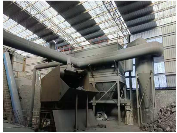
原料准备间：粉尘收集管道+旋风+布袋除 尘器+排气筒
