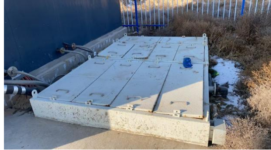
一体化处理设施
