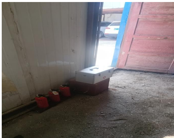
危废库灭火器、急救箱
