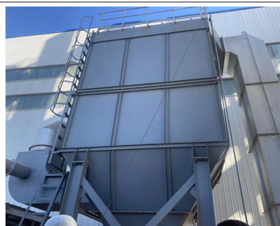
给料工段布袋除尘器
