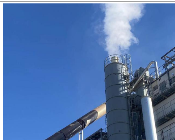
矿料筒仓滤芯式除尘器
