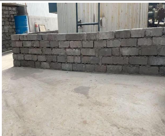
沥青储罐围堰
