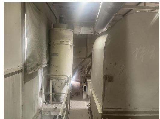
搅拌楼2#脉冲布袋除尘器
