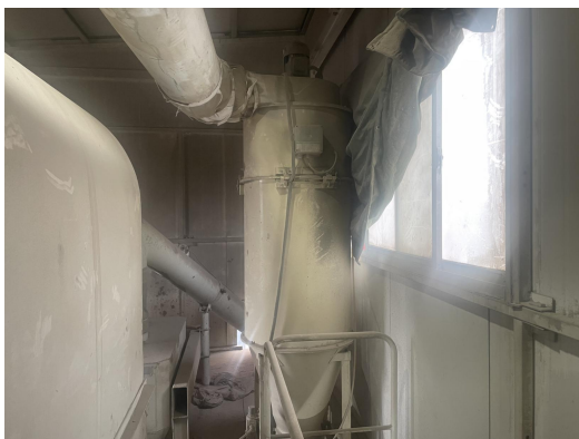
搅拌楼1#脉冲布袋除尘器
