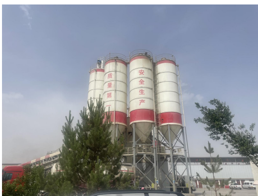
4个水泥筒仓及无动力滤芯除尘器
